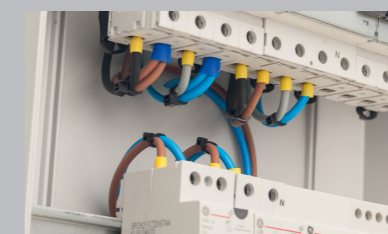
Velký prostor pro kabeláž Wide space for the cabling
